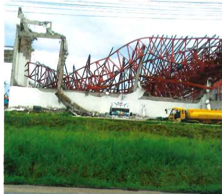
Edificio destruido por el tifón
